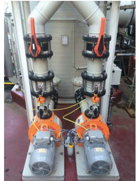
Pompes centrifuges PP de recirculation.
